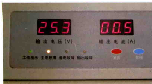
图6-23 主电故障时，智能电源盘上的“主电故障”指示灯点亮
