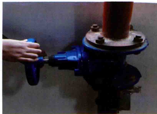
图10-15 关闭消防炮入口阀门
