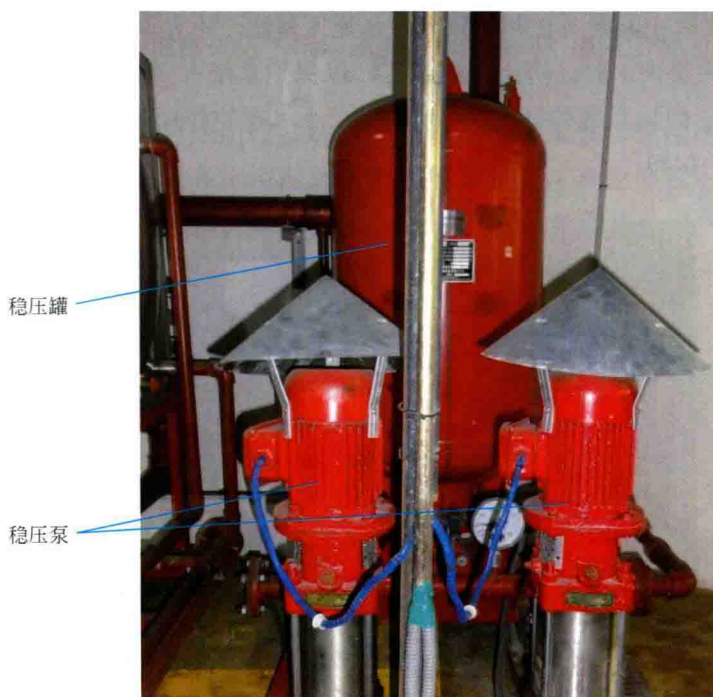
图 10-38 消防增压稳压设备
