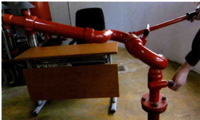
图 10-12 调整消防水炮角度
