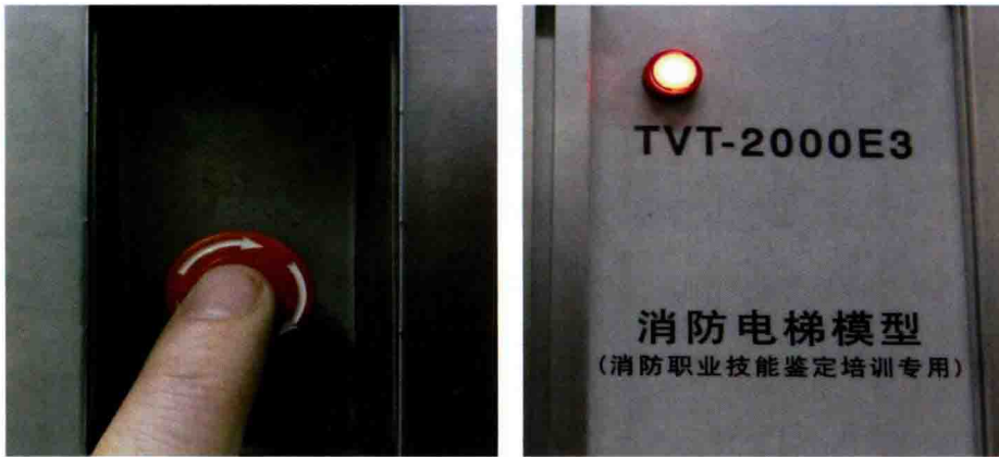
图 10-56 按下消防电梯按钮
