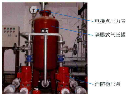
图5-14 消防稳压装置
