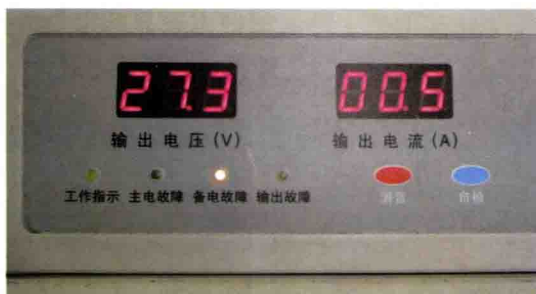
图6-24 备电故障时，智能电源盘上的“备电故障”指示灯点亮
